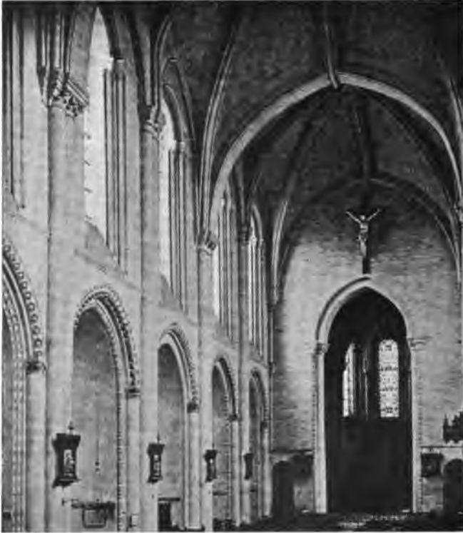
Fig. 150. — Voûtes sexpartites sur la nef de l'église de la Trinité à Angers. Relèvement de la naissance de l'arc doubleau secondaire.
